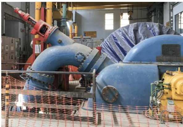
Détail de la centrale endommagée
