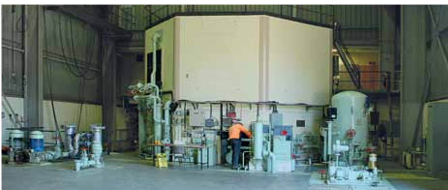
▼ Vista do antigo gerador da UHE de Fisher
