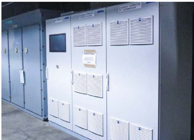
Шкафы системы возбуждения
